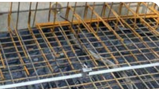
Anschlussgarnitur an den Fundamente der (Bild: Elvatec AG)
