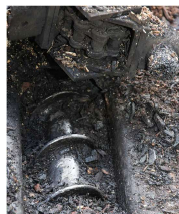
Situation nach einem Rückbrand aus dem Ofenraum: Beim Freilegen zeigt sich, dass die Hackschnitzel nicht nur oberflächlich, sondern auch in der Tiefe in der gesamten Austragung verkohlt sind. (Bild: IFS/Schallmoser*)
